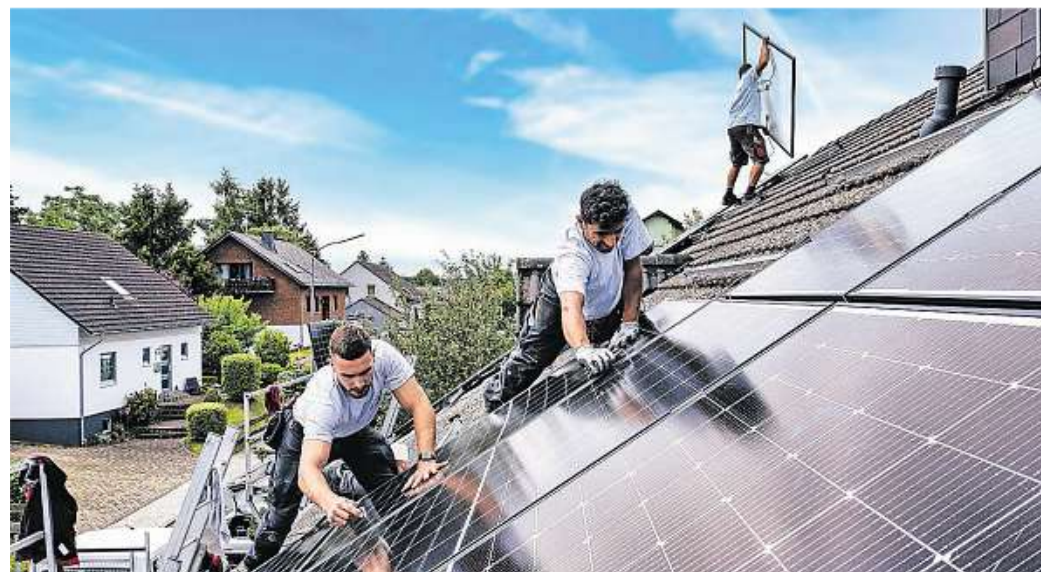
Eine Solaranlage auf dem Dach zahlt sich aus.
