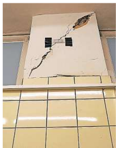
Dieser Riss in der Sporthallendecke wird überwacht.
